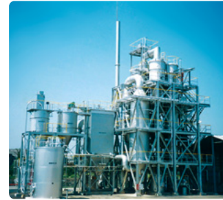
汚泥焼却高速流動床炉
